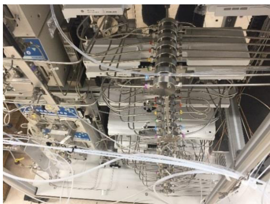
Komplexe technische Ausführung mit zahlreichen Ventilen und Pumpen.
